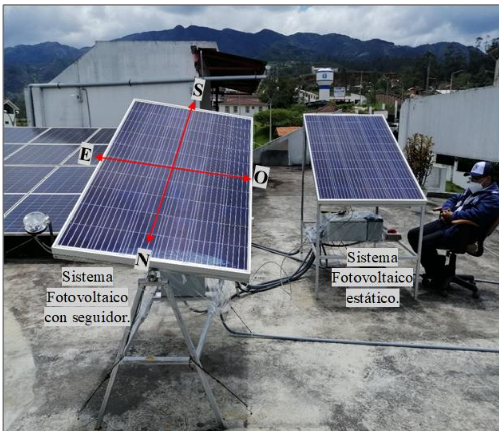
Figura S7. Sistemas fotovoltaicos instalados in situ.
