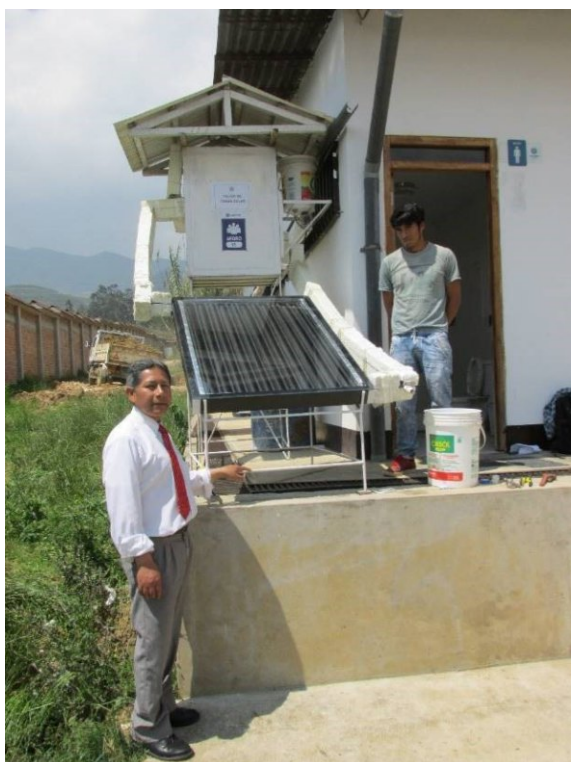
Figura 2. Terma solar con colector de tubos de 3/4" de PVC.
