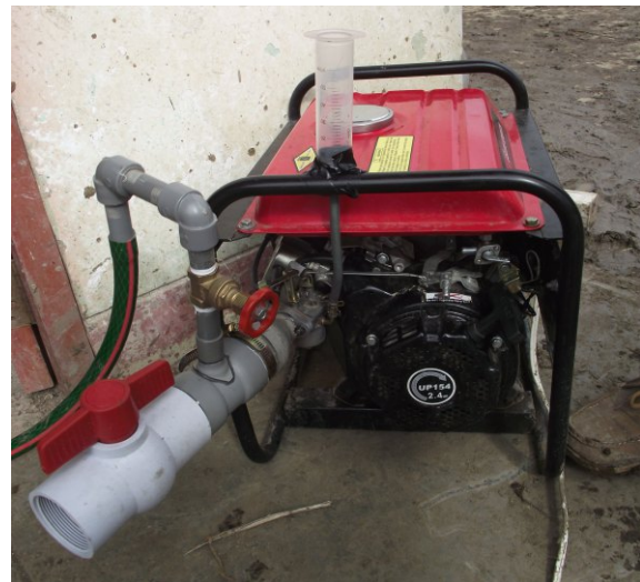
Figura 1. Tercera prueba. Grupo electrógeno de 1 kW, generando 244 W a biogás.
